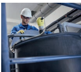
Prüfung der Iod-Rückgewinnungsanlage: SAVA-Mitarbeiter Peter Bielenberg. © REMONDIS SAVA
