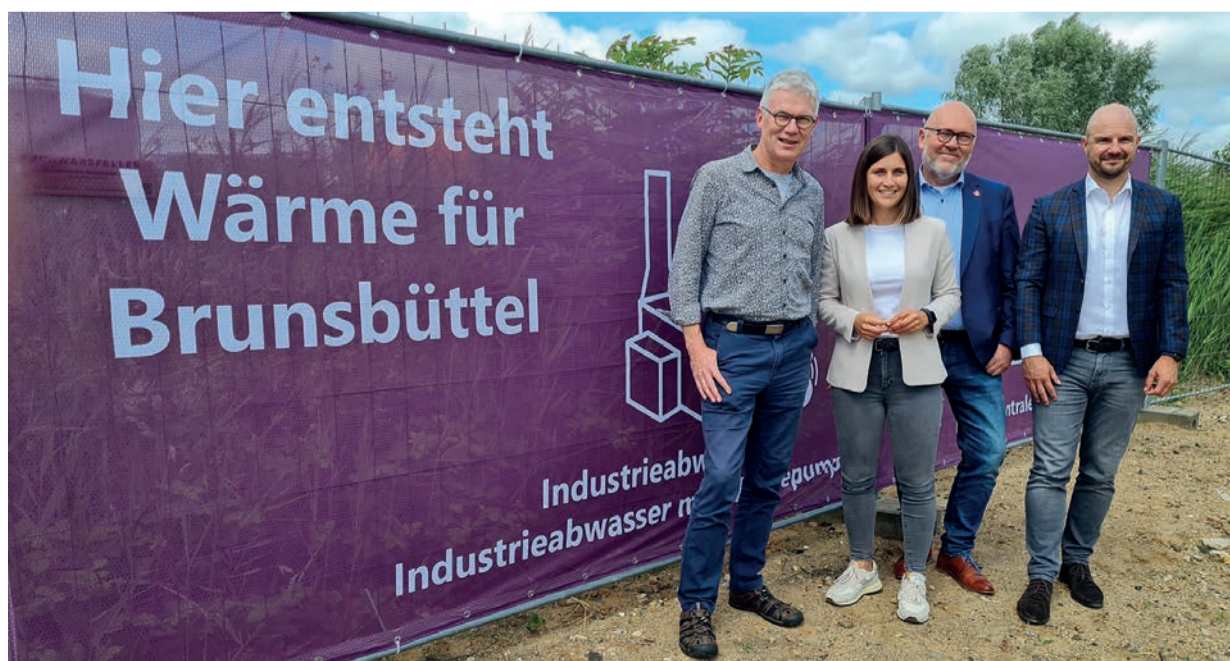
Auf dem Baufeld für die hochmoderne Energiezentrale von Westholstein Wärme: (v.l.) Dr. Guido Austen, Patricia Dau, Bürgermeister Martin Schmedtje und Andreas Wulff. © Jens Neumann / Westholstein Wärme GmbH
